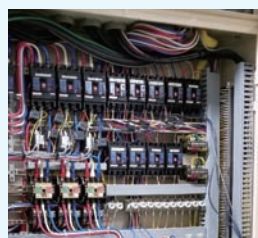
控制盤內機器異常發熱
